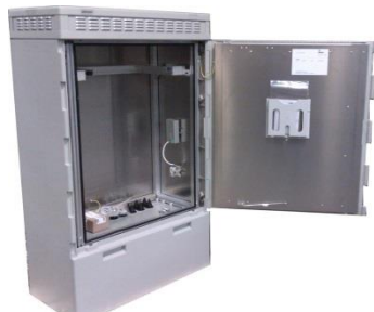
Dobbeltvægget plastskab til aktivt udstyr. Monteret på havneareal. Udstyr i 19" profil hænger vertikalt.
